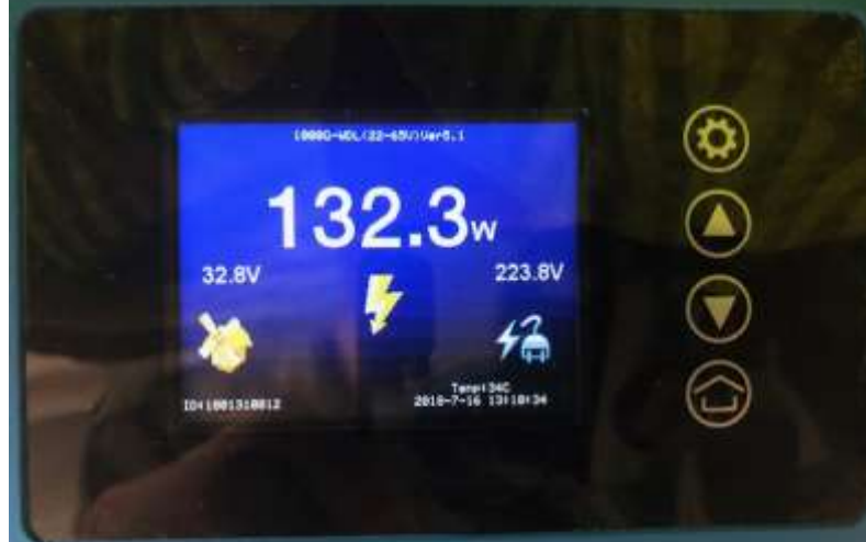
Betriebsdatenanzeige des SkyWind Wechselrichters
